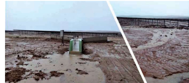
תחנת המדידה בעת אירוע גשם. ניתן לראות את הוריסה הרדודה והמשטחית מכיוון האגן. בתמונה משמאל זרימת המים ביציאה ממתקן המדידה
